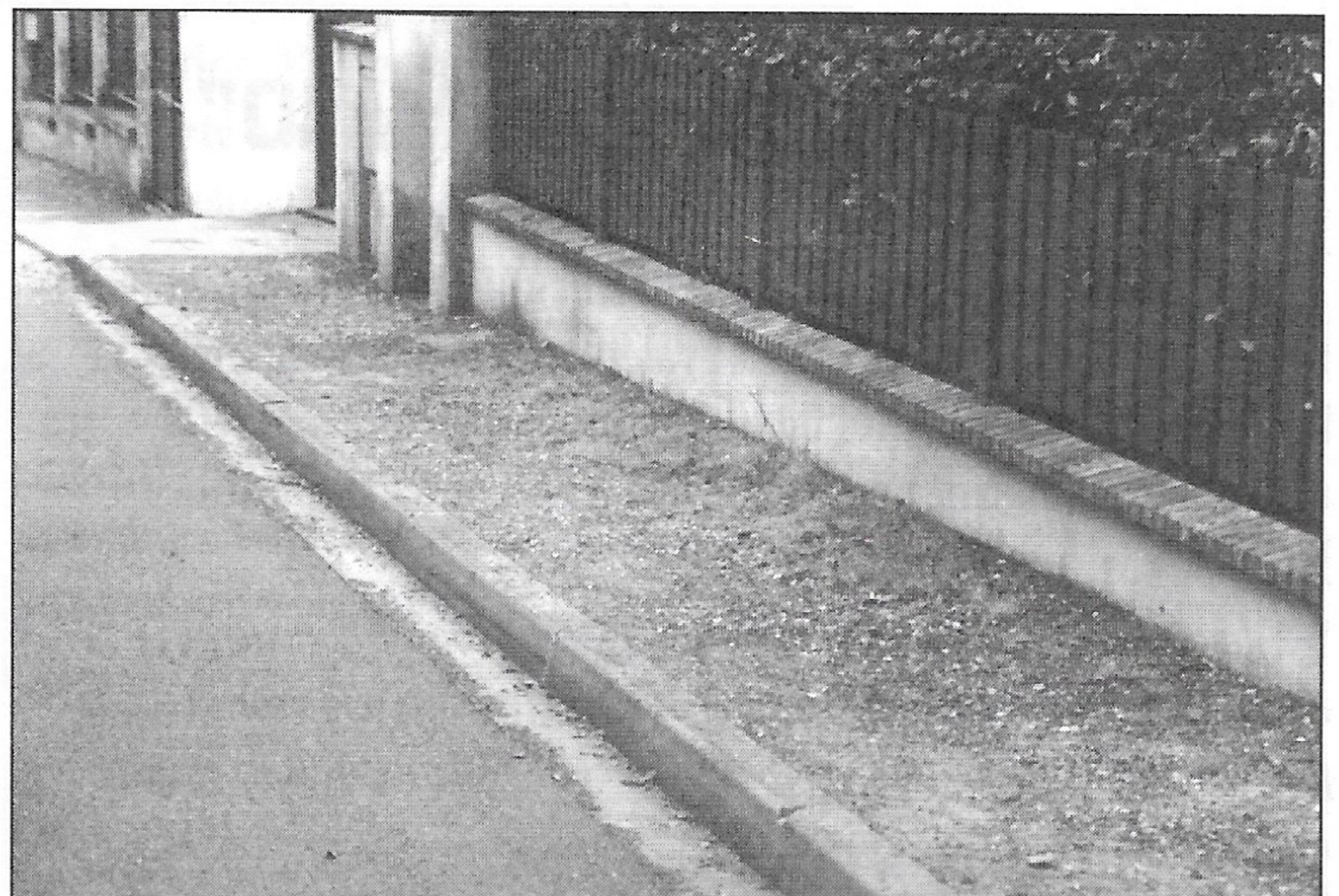
Le revêtement en grave cède facilement la place aux mauvaises herbes et nécessite un minimum de nettoyage sous peine d'être vite détruit par des végétaux dits "conquérants". Le riverain peut nettoyer lui-même manuellement ses abords, ainsi le passage des services techniques et du désherbage chimique est évité.
